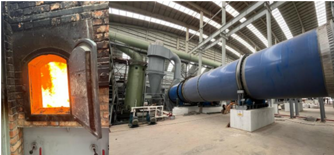
Gambar 5. Sistem Pengeringan dan Ruang Pembakaran RDF (Furnace) Sumber : Dokumentasi lapangan
