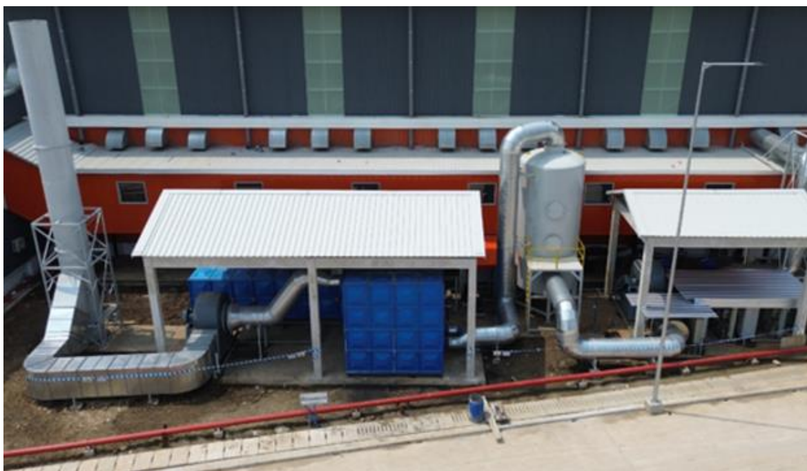
Gambar 10. Sistem Pengendalian Bau (Deodorizer) Sumber : Dokumentasi lapangan
